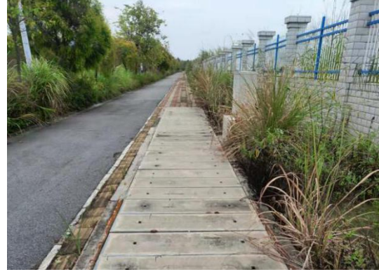
电缆沟检查井
